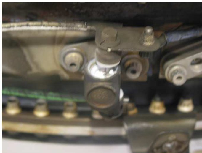
Figura 2 – Base de porcelana dos termopares rompida.
