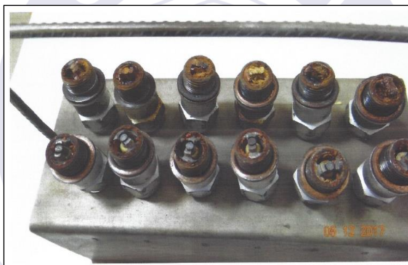
Figura 1 - Vista geral das velas com oxidação.
