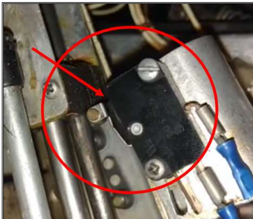
Figura 3 - Microinterruptor sem acionamento com o manete de potência em IDLE.
