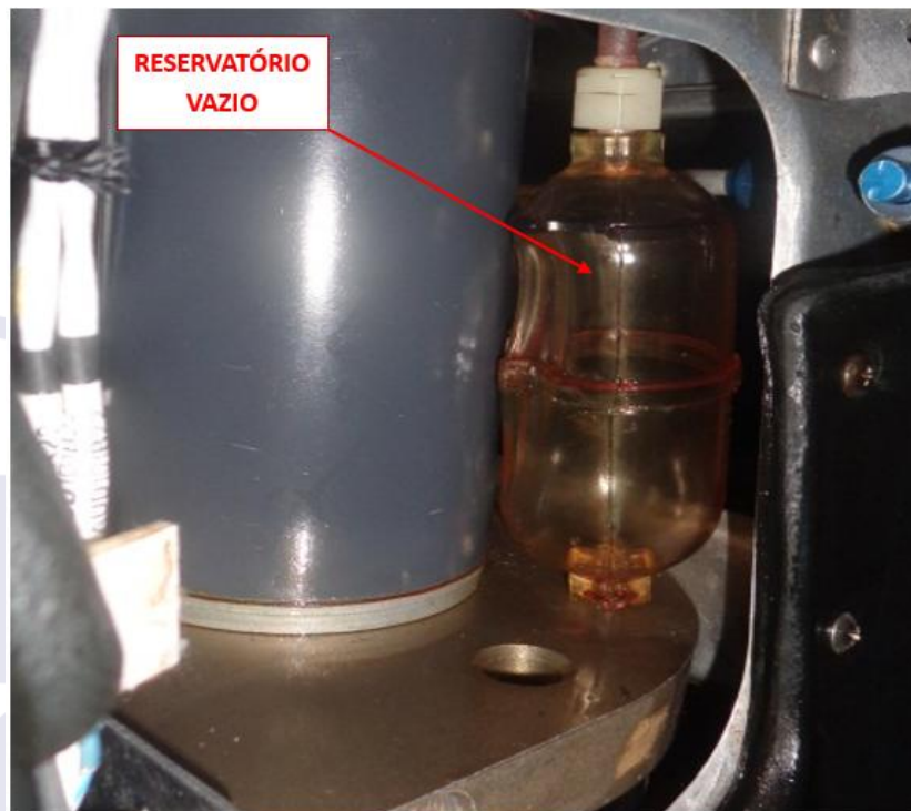
Figura 1 - Conjunto eletromecânico com o reservatório de fluido hidráulico vazio.
