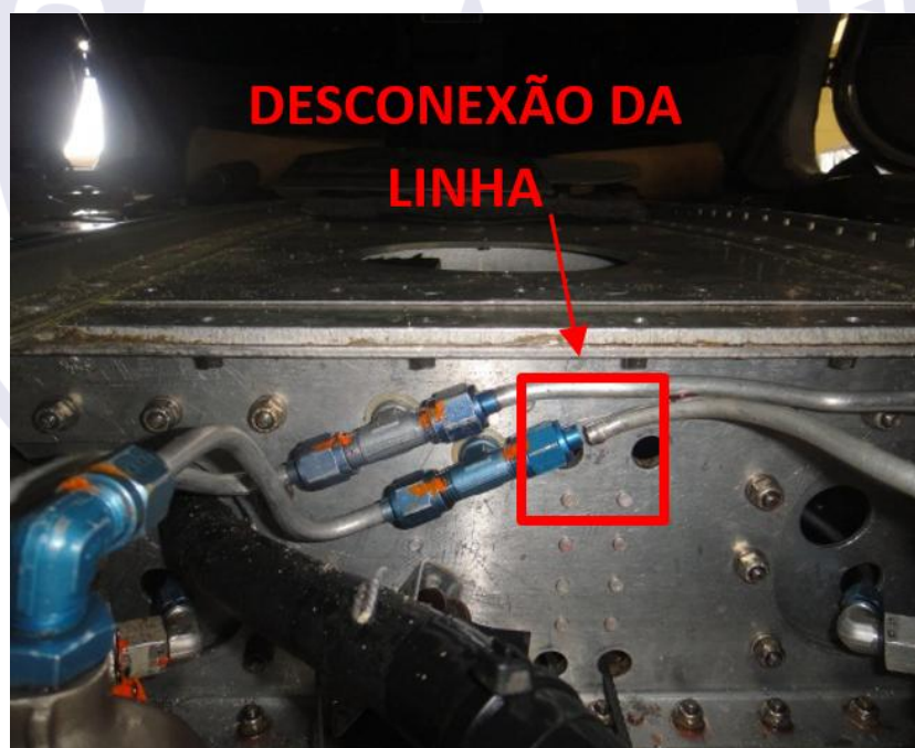
Figura 2 - Tubulação hidráulica danificada.
