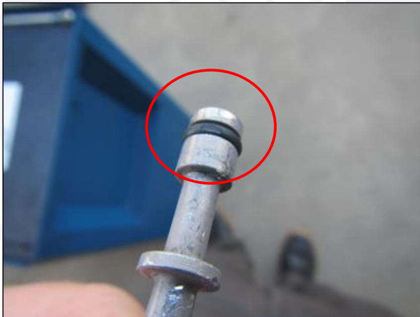
Figura 9 - Anel de vedação do tubo de transferência desgastado ( packing ).
