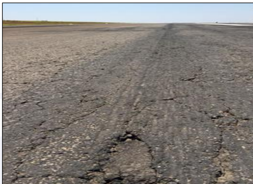
Figura 2 - Pontos de desagregação asfáltica na pista de SBMG.
