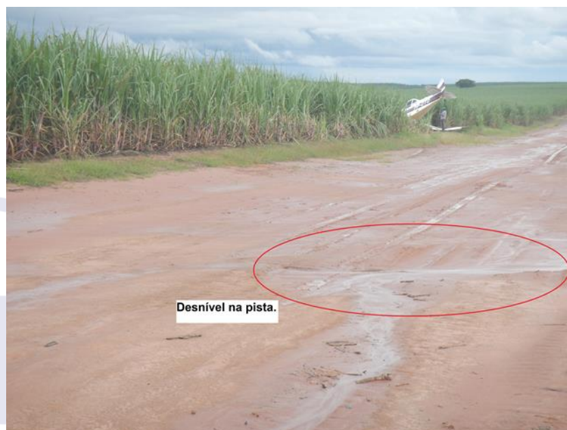
Figura 2 - Vista do desnível na pista.
